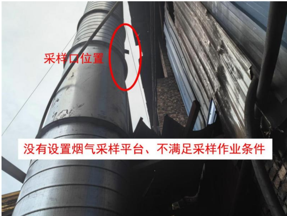
图 4 2024 年 5 月 30 日，督察组现场督察发现，湖南金泉厨具有限公司没有设置烟气采样平台、不满足采样作业条件
