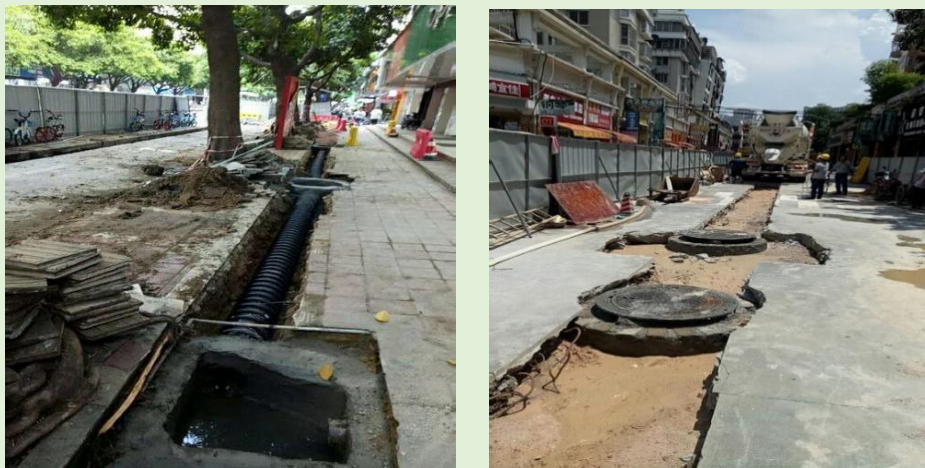
某城市为商铺预留接户井
